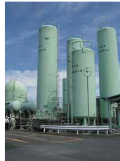
都市ガス製造施設
