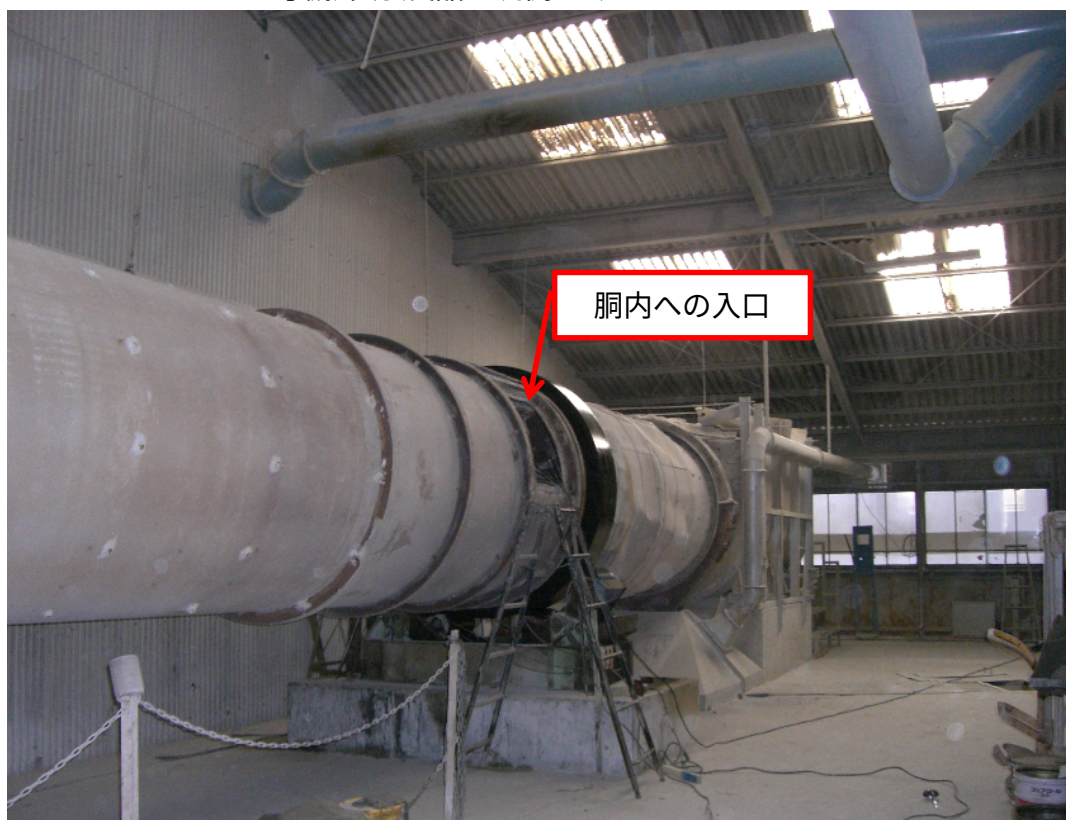
・ロータリードライヤー2号機外観（製品上流側より）
