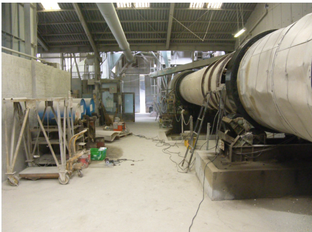
・ロータリードライヤー2号機外観（製品下流側より）
