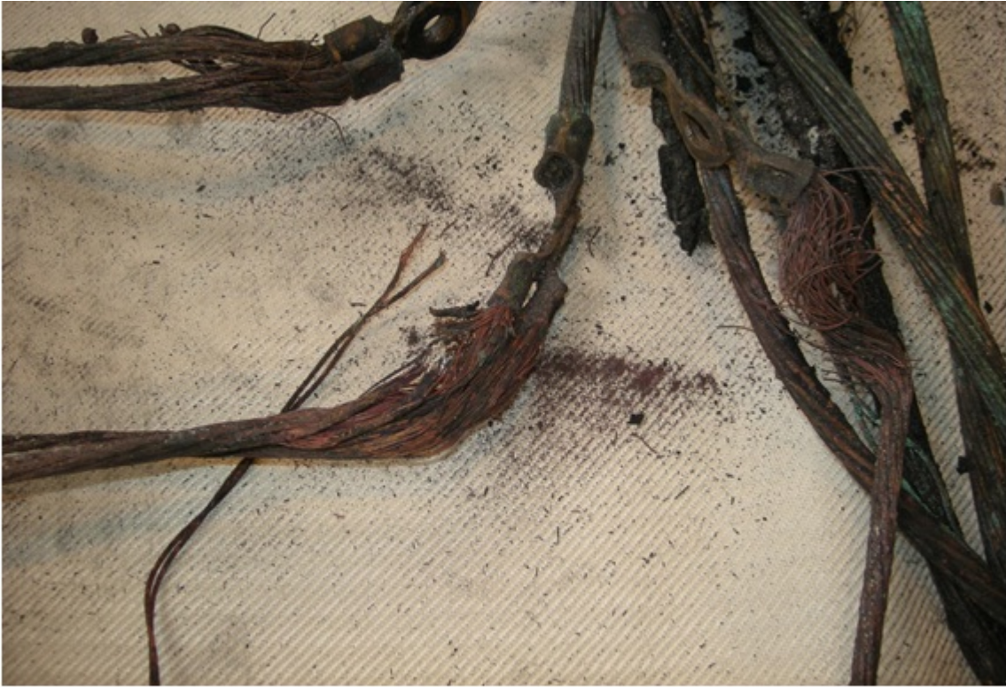
電源ケーブルの素線切れ箇所↓ (素線切れの端部に溶融痕あり) ↓
