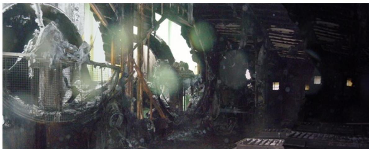
焼損した送風ファン室の内部
