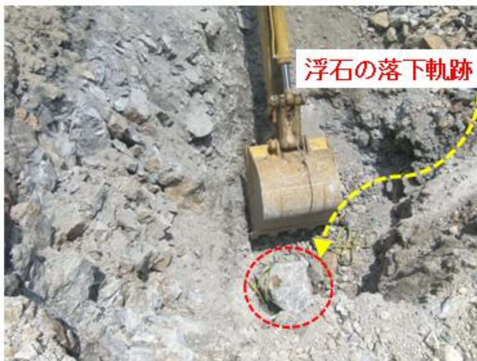
災害発生箇所(赤丸が落下した浮石)
