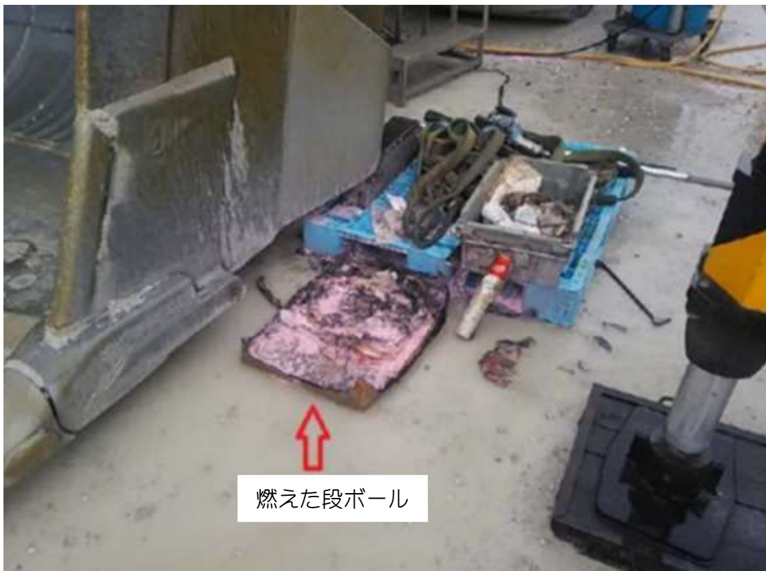
写真2 火災発生箇所
