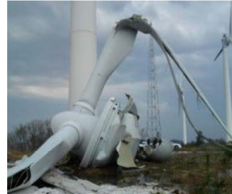
強風により損壊した風力発電設備 (平成25年3月京都府太鼓山)
