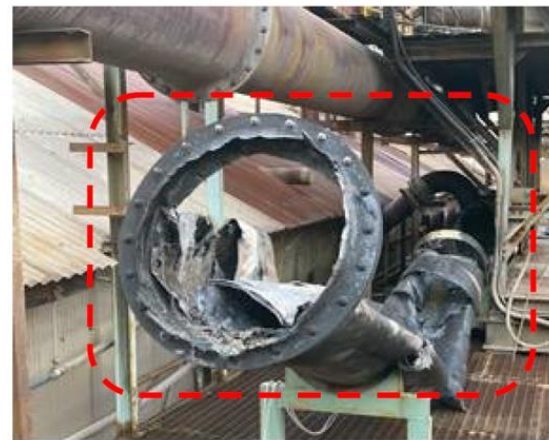
災害発生時の状況(焼損した煙道)
