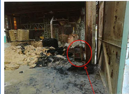
焼損したスポットエアコン
