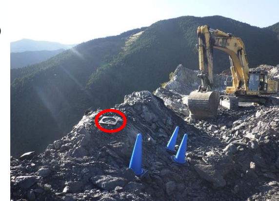
罹災者転落推定箇所
