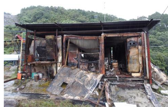
全焼した碎鉱設備電気室
