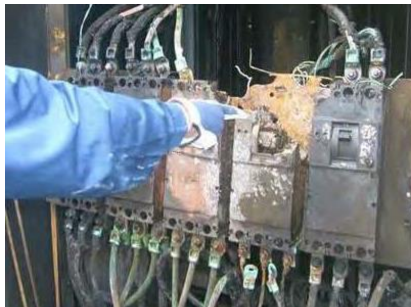
焼損したブレーカー
