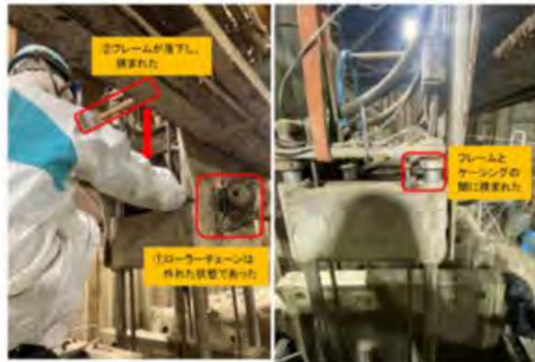
右写真は、罹災者を救出する際にスリングでケーシングを吊った状態。このため、罹災時よりもフレームとケーシングの間が開いている。
