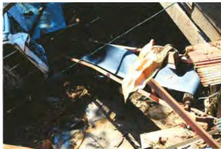
選鉱場と貯鉱場を結ぶベルトコンベアの損壊状況
