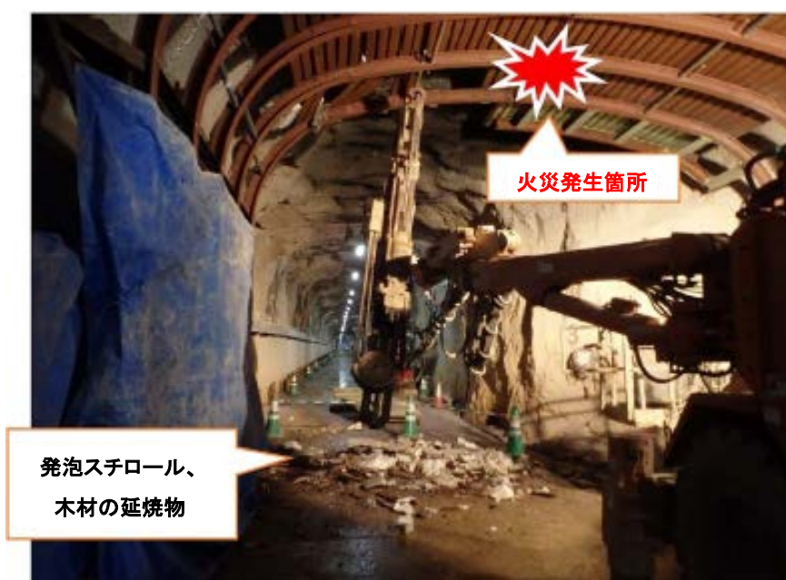
火災発生箇所の状況
