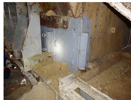
シュート側部に設置した開口部
