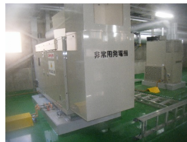
新設 非常用発電機
