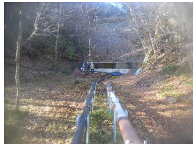
廃水（浸透水） 集水・導水
