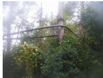
台風豪雨→導水管破損 原水導水管
