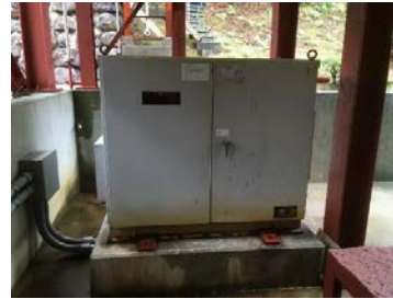
3台確認 非常用発電機
