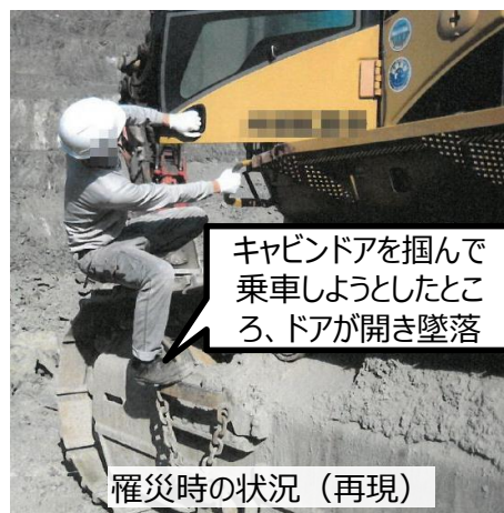
重機からの墜落（令和2年8月）
