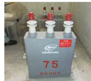
電力用コンデンサー
