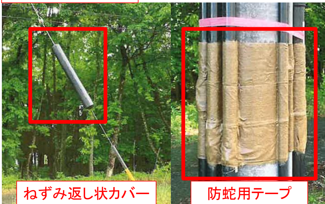
対策品施工後
