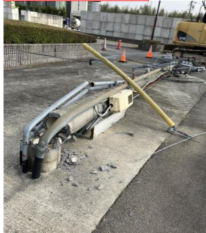
倒壊した構内第一柱
