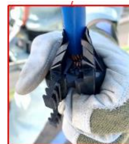
【流入箇所】 青相引込幹線 (引込線用 PJ コネクタ部分)
