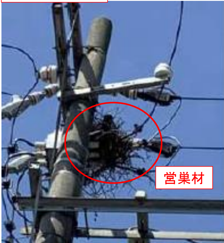
営巣材除去前
